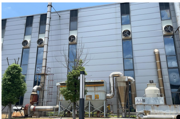
废气处理设施
